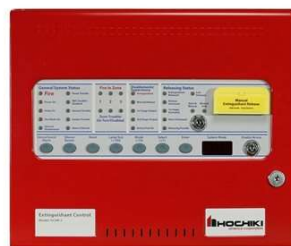
Hệ thống tủ thường, xả khí
